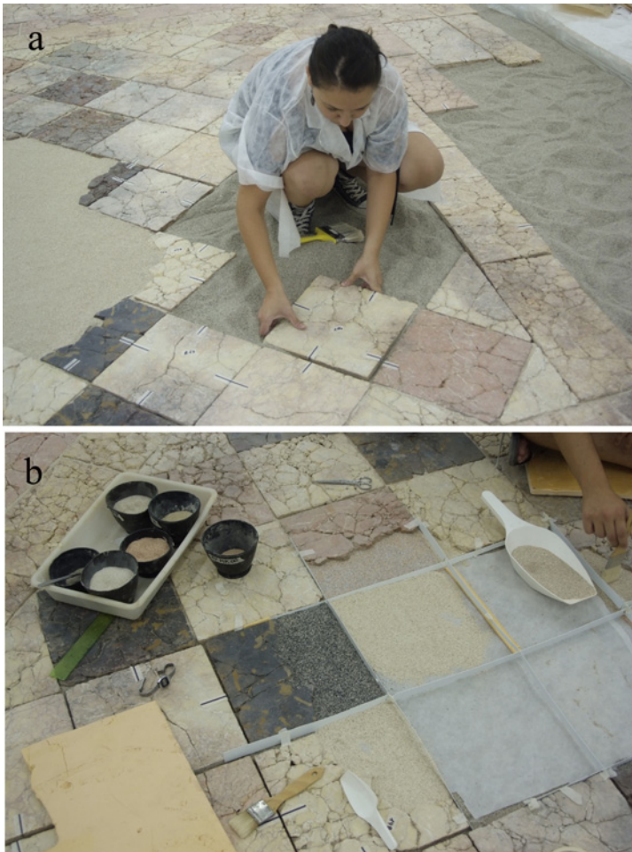
Fig. 4. (a) Montaje del pavimento sobre una base de arena; (b) reintegración de lagunas con gravillas sueltas de diferentes tonalidades.
